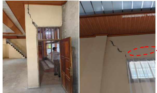
Gambar 5.a-b.Retak geser diagonal sudut bukaan dengan lebar celah > 10 mm pada dinding bata bagian belakang bangunan. Gaya/beban geser yang bekerja pada portal beton akan ditransfer dari satu sisi ke sisi dinding lainnya melalui mekanisme deformasi portal beton bertulang
