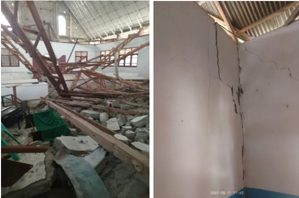
Gambar 3.1. Kondisi bangunan pasca gempa
